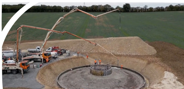
Parc éolien de Bernay Saint Martin - mars 2026
